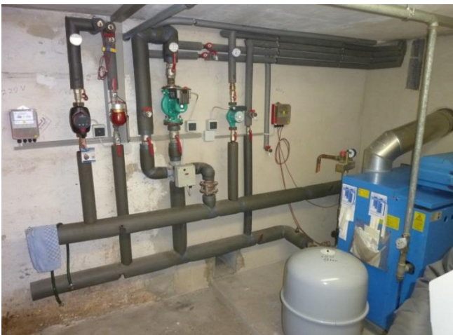
Abbildung 54: Heizungsanlage Grundschule Midlum
