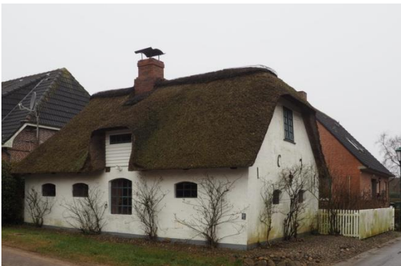
Abbildung 61: Augenscheinlich sanierungsbedürftiges Gebäude
